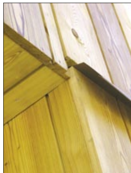
Foto 5. Fotel 4 kujutatud maja ukse kohal olev aste. Õhu juurdepääs tuulutusvahesse on suletud. Voodrilaudade jätkamine veepleki abil pikkuses (ülemine ots on vee eest kaitstud) on korrektne, kuid laudade alumised otsad on jäetud veeninaks saagimata (vt fotod 14 ja 15). Tuleb jälgida, et veeplekk ei katkestaks tuulutusvahet (kui roovitis on paigaldatud fotol 1 näidatud või muul sarnasel viisil, ei sega roovi külge kinnitatud veeplekk tuulutust).
