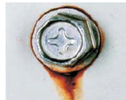
Korrodeerunud modifitseeritud martensiitteras
